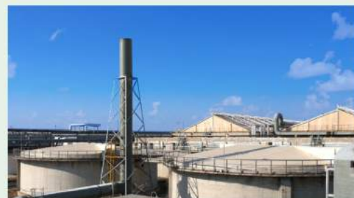
污水预处理废气收集处理系统
